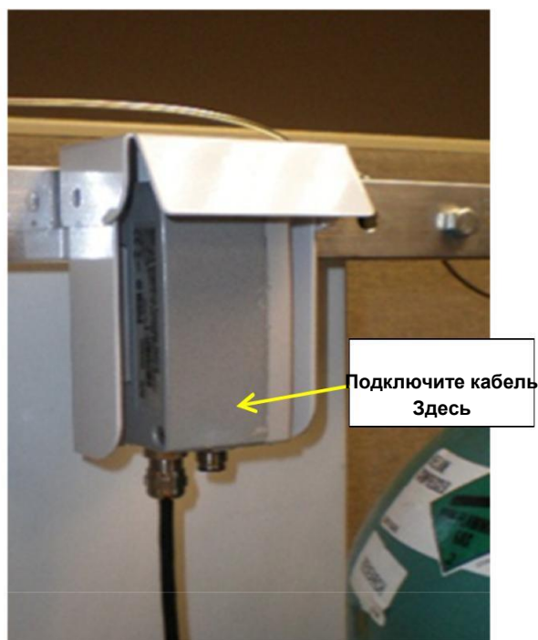
Рисунок 14 Установленный дождевой экран
