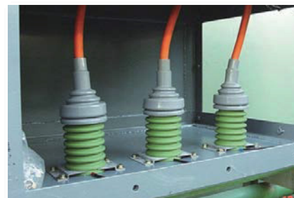
安装的电容耦合器
