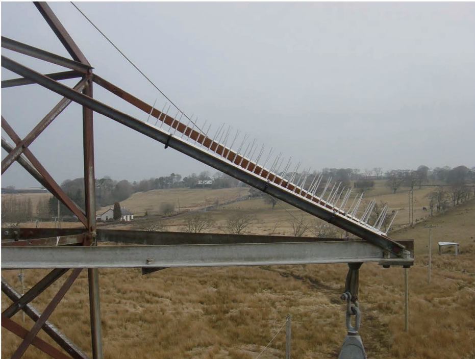
图7 垃圾填埋场附近铁塔上安装的防鸟板
