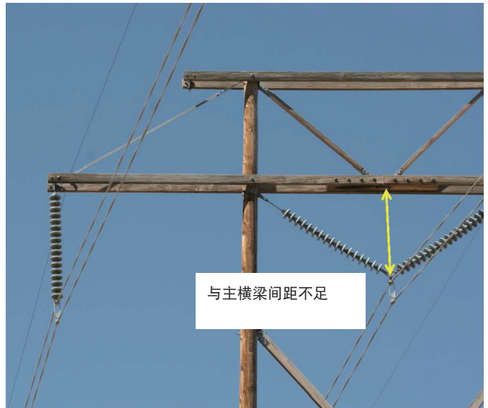
图4 - 中间相线距离主横梁过近
