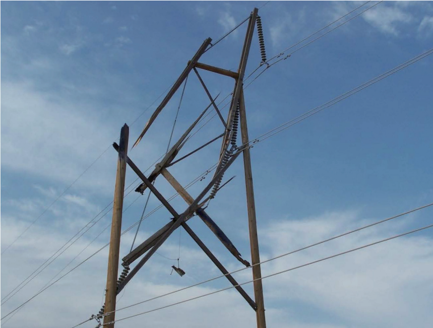
图7 因火灾倒塌的杆塔结构
