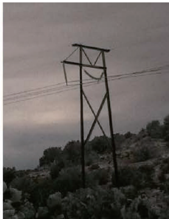
图6 - 冰风暴造成的杆塔结构损坏
